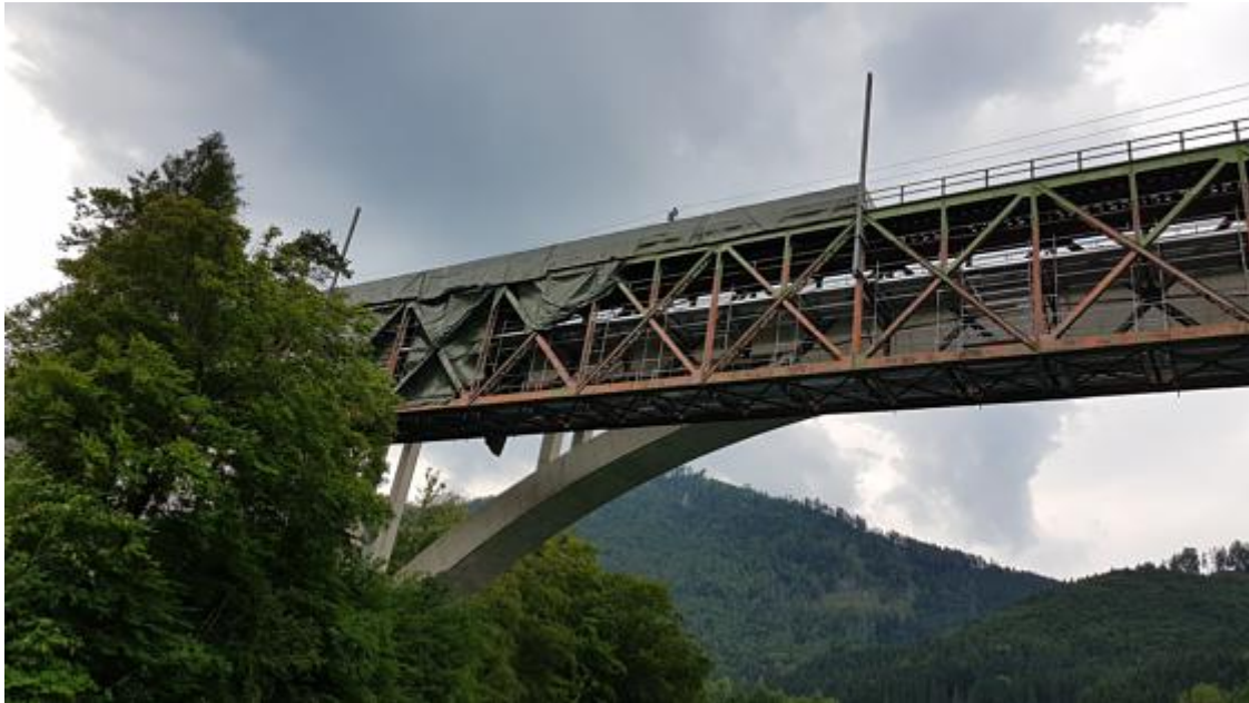
Säuberungsaktion an Eisenbahnbrücke mit Folgen Bild: privat
